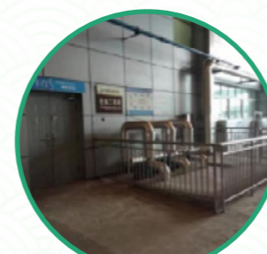
包装物流洗瓶水回收管道
